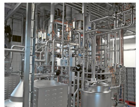
Das Chaos hat System: Hier erfolgt der Wärmetausch.
